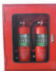
ตู้ดับเพลิงท่อกู้
