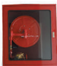
ตู้ดับเพลิง Hose Reel
